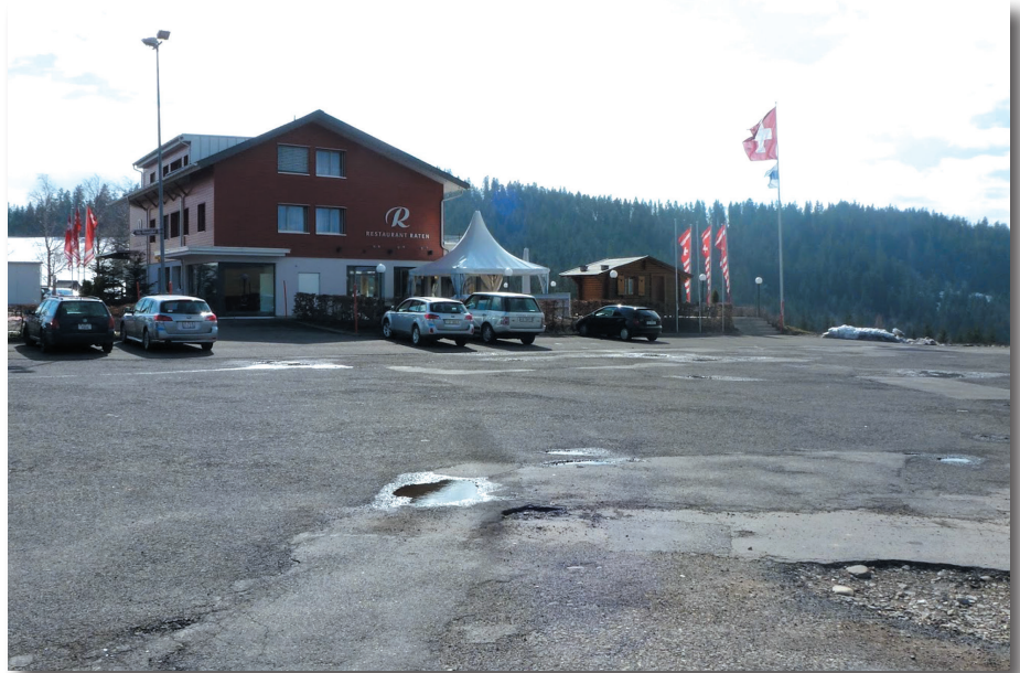
Der Ratenparkplatz muss dringend saniert werden.
