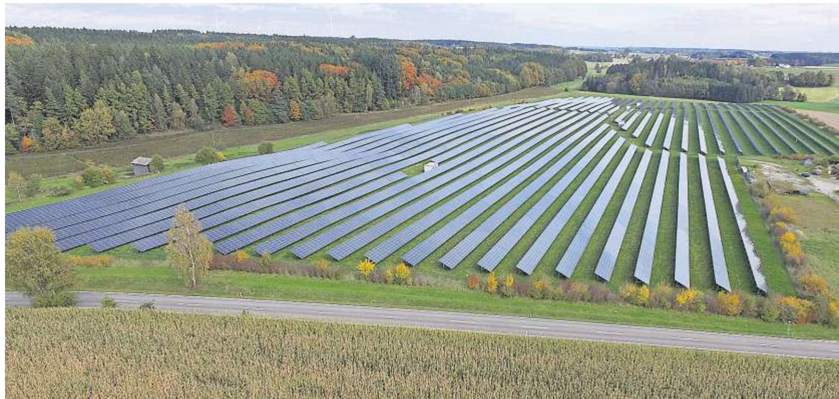
Das Foto zeigt eine für den am Diendorfer Berg geplanten Solarpark vergleichbare Freiflächenanlage der Energiebauern GmbH.
