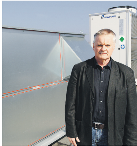
Lüftung und Klima auf dem Dach: Ralf Weitemeyer vor den Einrichtungen auf dem Dach oberhalb der Praxis-Etagen.
