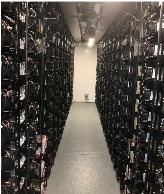
Batterie de stockage Ze Energy - Senillé Saint Sauveur (Vienne)
