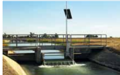
I Flume Gates lungo i canali misurano continuamente portate e livelli d'acqua
