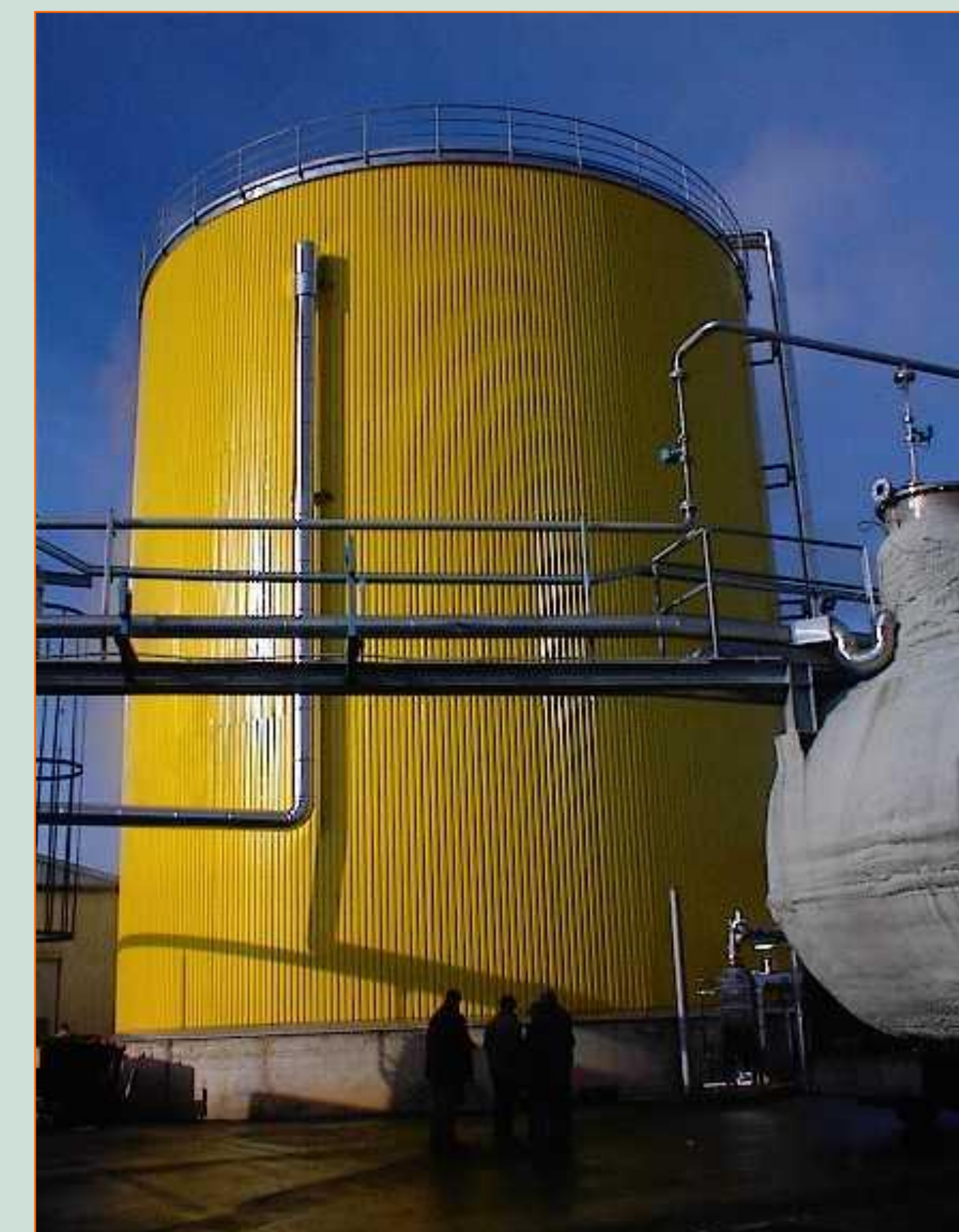
Biogasanlage der Frieweika e. G., Weidensdorf/Sachsen
